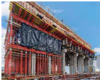
HD 200 Schwerlaststützen als vollflächiges Traggerüst. Die HD 200 Scheiben wurden gekoppelt, um auch in großer Höhe die Lasten des 3,20 m starken Stahlbetonauflegers für den Generator sicher abzutragen.
