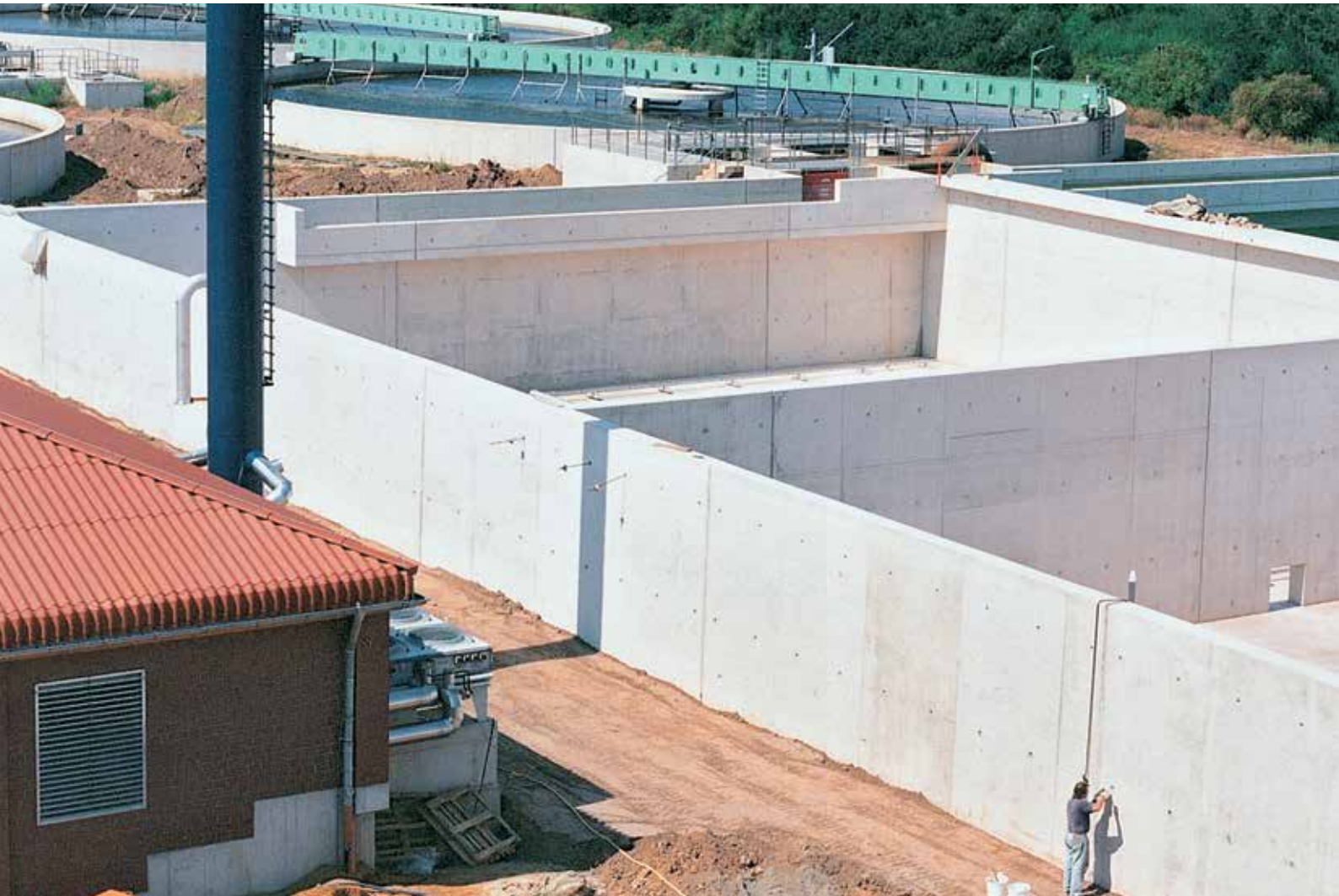
Kläranlage in Hameln, Deutschland.
