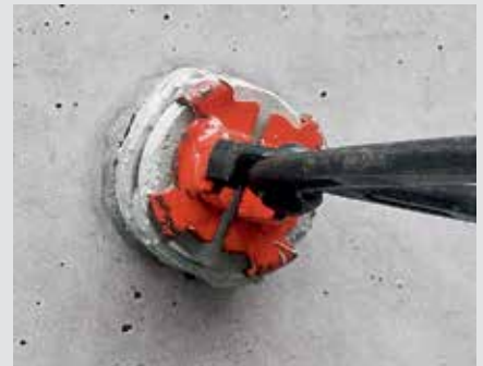
Den Betonkonus in den Abdruck stecken und mehrmals leicht drehen, damit sich der Dichtungskleber gleichmäßig verteilt.
