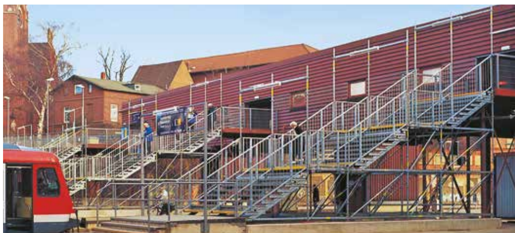
Der Zugang zu den Bahngleisen über temporäre Treppen und eine temporäre Fußgängerbrücke ermöglichte die Trennung der Baustelle für die neuen Zugänge vom Publikumsverkehr zu den Bahnsteigen.
