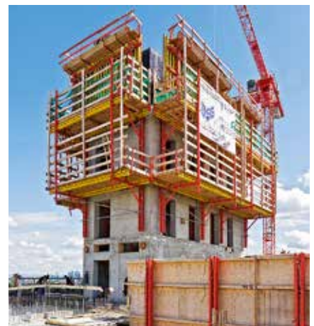
Das RCS Schienenklettersystem in der Anwendung als Schalungsgerüst für den Gebäudekern und als Kletterschutzwand an der Fassade.
