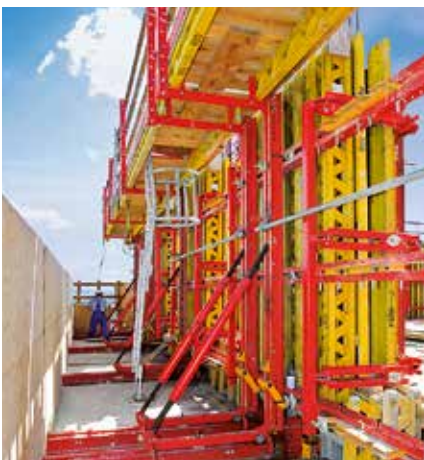
Diese Säulenschalungen im Fassadenbereich klettern mit der RCS Selbstklettertechnik kranunabhängig nach oben. Gleichzeitig bietet die Einhausung Schutz vor Wind und Wetter.
