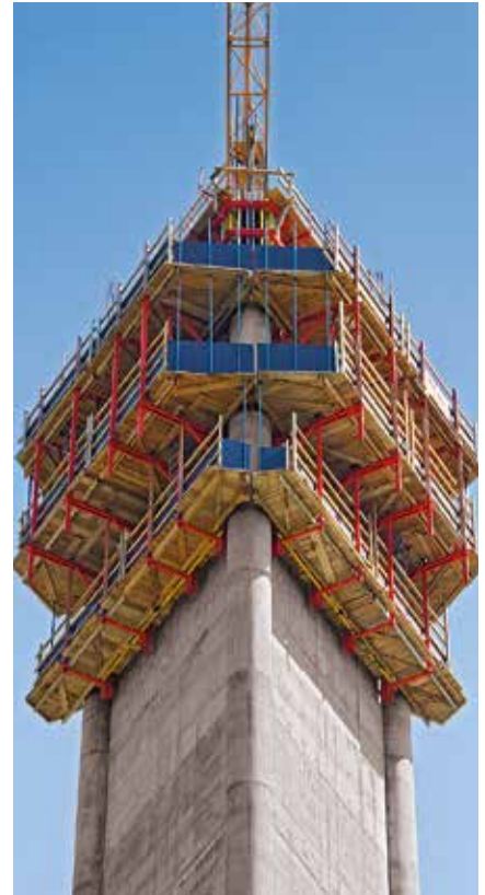
Alternativ zu einer vollständigen Einhausung bieten auch Gerüstrohre oder Geländerbretter sicheren Seitenschutz.
