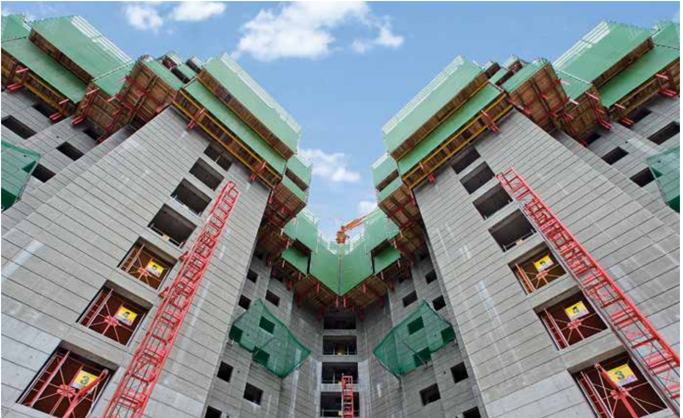
Auch komplizierte Grundrisse lassen sich mit dem Schalungsgerüst RCS C dank der Flexibilität wirtschaftlich klettern – schienengeführt und kranunabhängig.
