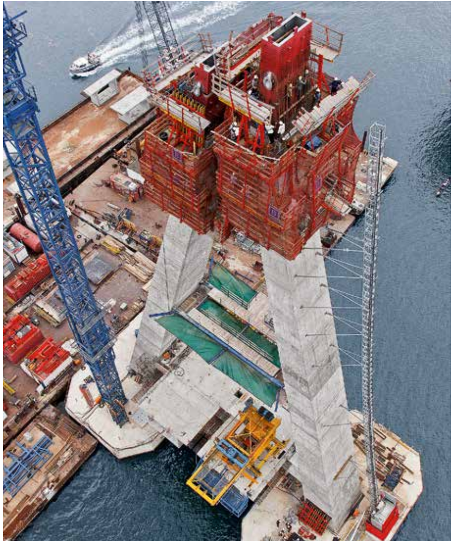
Für den Pylon einer Brücke in Nigeria kombinierte PERI die Systeme ACS und RCS. Kranunabhängiges Arbeiten sorgte für einen zügigen Baufortschritt trotz der sich kontinuierlich ändernden Pylonneigung.
