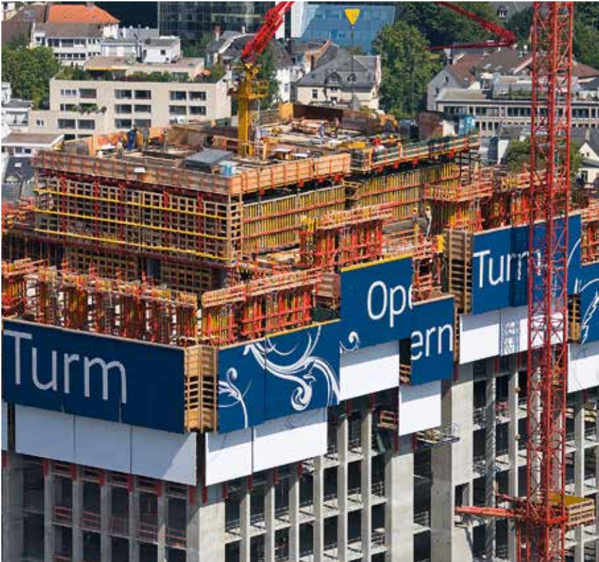
RCS bietet sichere Arbeitsplätze auf höchstem Niveau – hier vollständig eingehaust.
