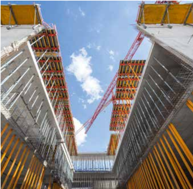
Die Faltbühne FB 180 in Kombination mit der MAXIMO Wandschalung sorgte für eine Einhaltung hoher Tempovorgaben.
