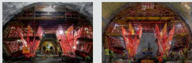
Durch den Teleskopsteher kann das Haupt-Tragwerk auch nach Wechsel in den deutlich größeren Querschnitt beibehalten werden.
