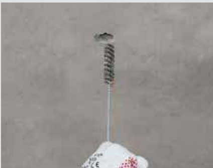
Schritt 1 Erstellung Bohrloch mit d = 22 \text{ mm} und t = 160 \text{ mm} (rechtwinklig zur Betonoberfläche); Reinigung des Bohrlochs mit Bürste und Ausblaspumpe
