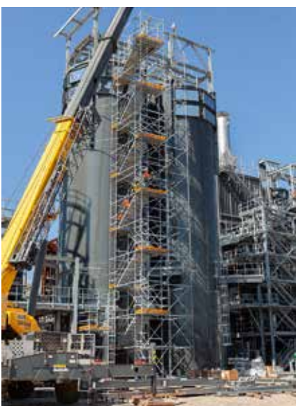
Gegenläufige Gerüsttreppen bieten eine große Kopffreiheit und kurze Laufwege bei hohen Aufstiegen.
