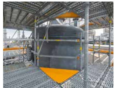
Zum lückenlosen Einrüsten von runden Anlagenbauteilen mit geringem Durchmesser kann auch das Eckblech genutzt werden.
