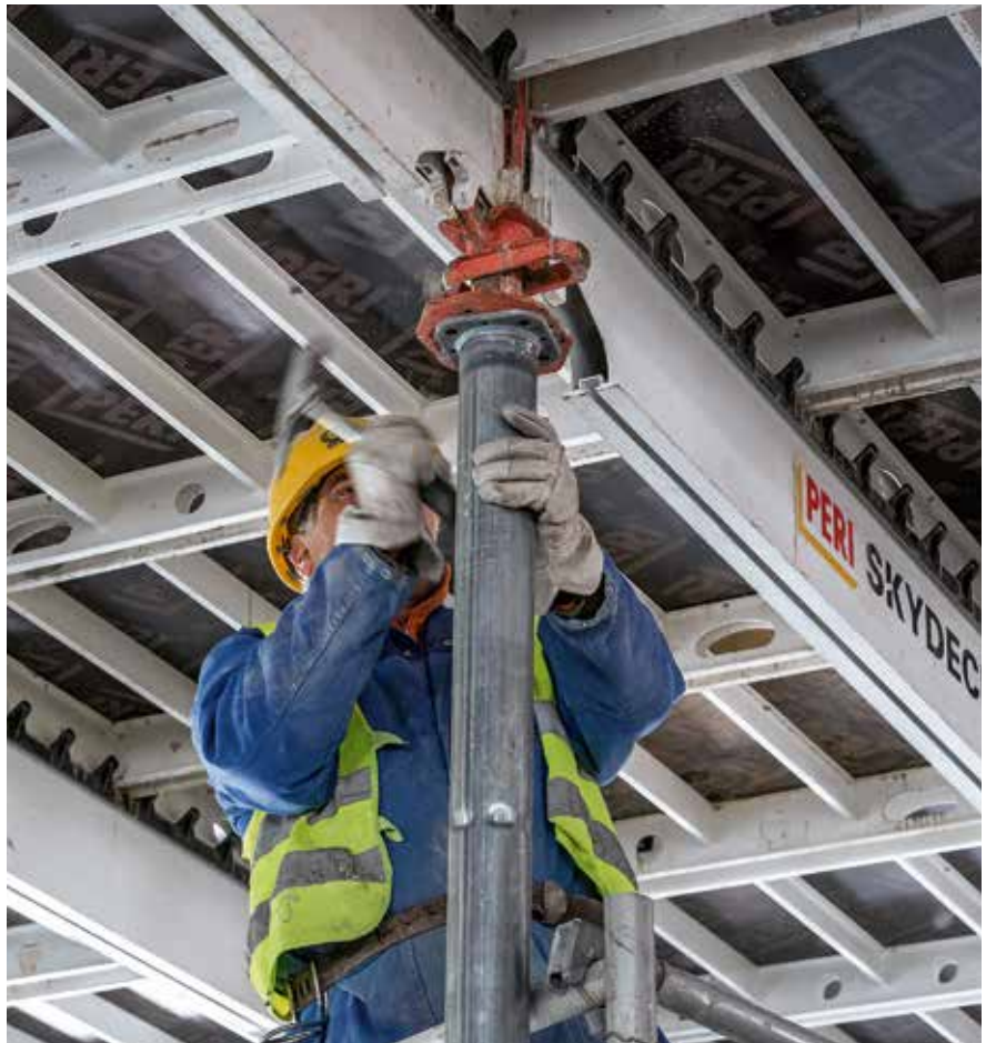
Einfaches Frühausschalen: Mit einem Hammerschlag senkt sich die Schalung um 6 cm ab. Nach dem Absenken der Fallköpfe wird zuerst das mittlere Paneel ausgeschalt, es folgen die angrenzenden Paneele.
